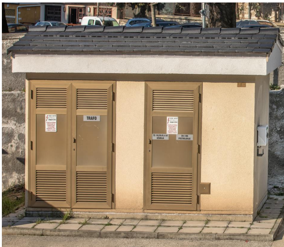
Slika 6. KTS 10(20)/0,4 kV Užarija sa ugrađenim solarnim crjepovima
