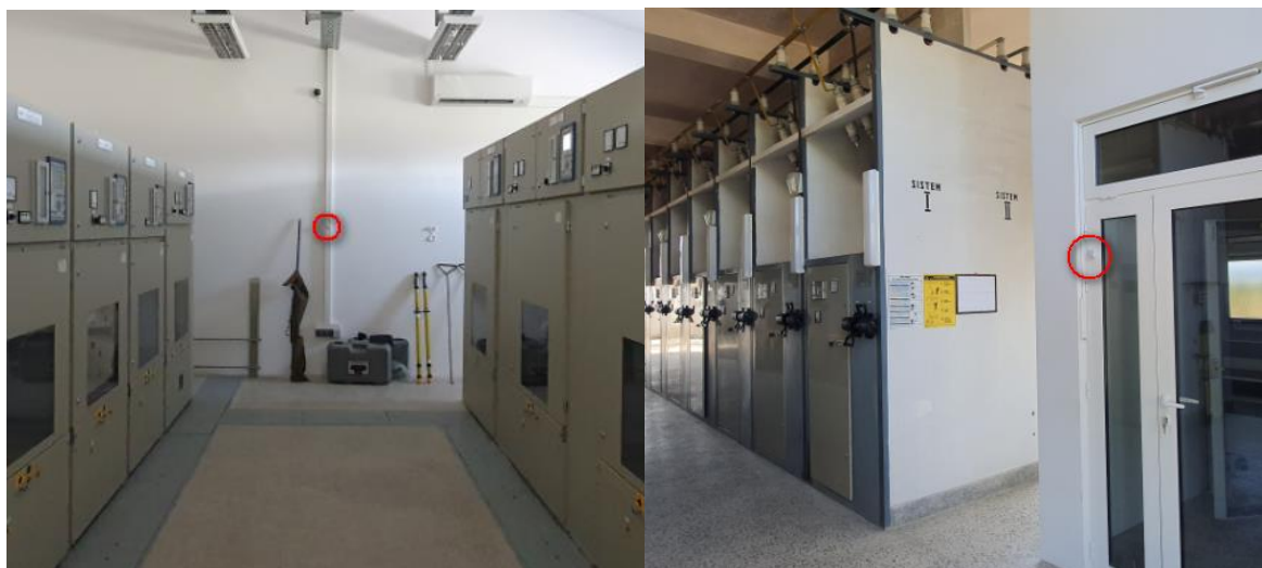
Slika 2.5 Lokacija montaže senzora u TS 35/10 kV Brod 4 i TS 35/10 kV Brod 2
