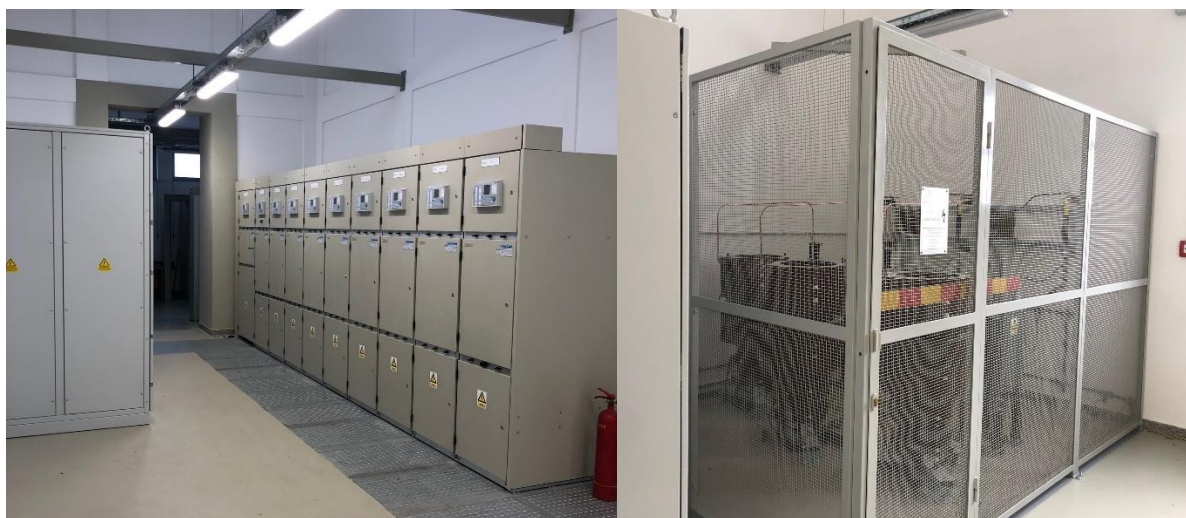
Slike 8. i 9. TS 110/35/10(20) kV Prelog izvedeno stanje – pogledi na nova postrojenja 35 kV i MTU
