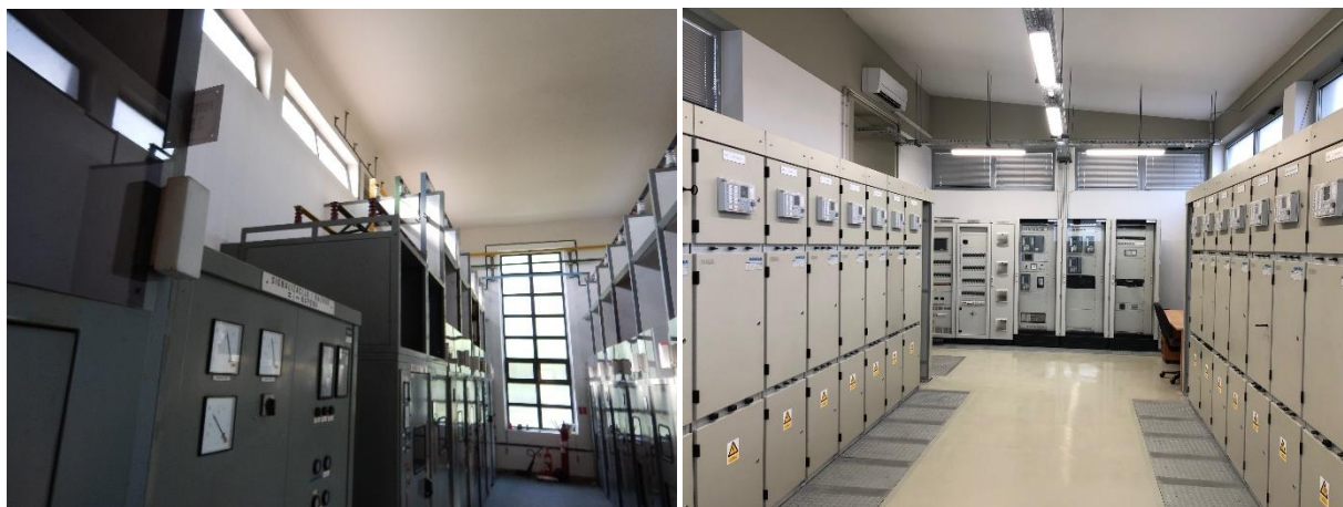
Slike 6. i 7. TS 110/35/10(20) kV Prelog izvedeno stanje – pogledi na staro i novo postrojenje 10(20) kV
