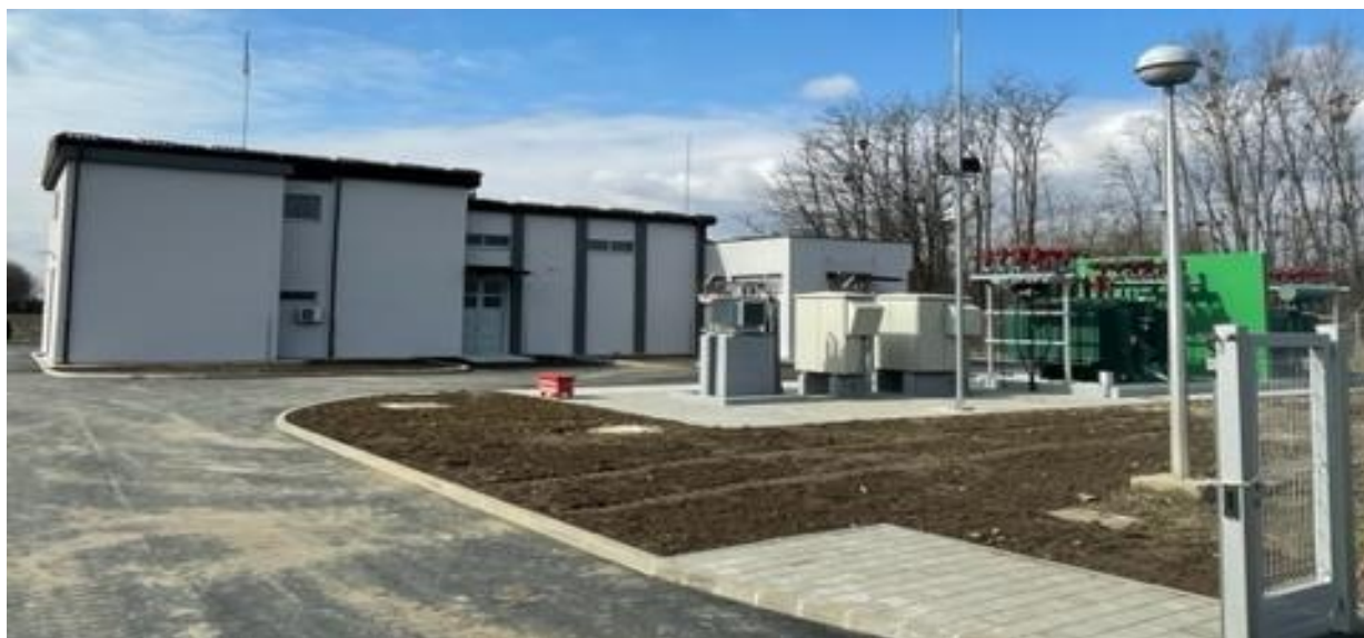
Slika 5. TS 110/35/10 kV Prelog izvedeno stanje – pogled na dio postrojenja za uzemljenje neutralne točke 10(20) kV i 35 kV, energetski transformator TR 35/10(20) kV 16 MVA i transformator TR 35/10 kV 8 MVA
