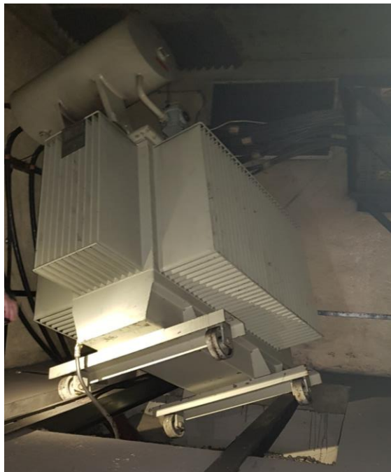
Slika 3. Transformator ispao iz ležišta u TS 10/0,4 kV (1TS1831)
