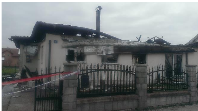
Slika 16. Oštećenja montažne kuće
