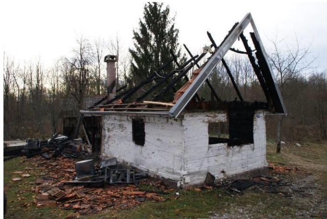
Slika 1. Požar drvene kuće
