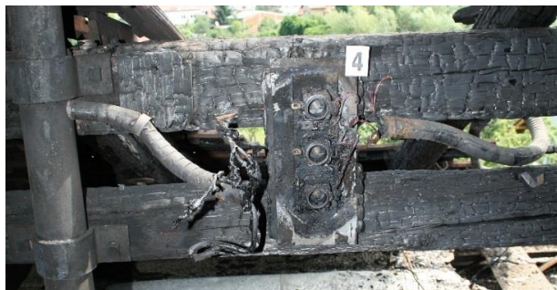
Slika 4. Mjesto nastanka požara i tragovi kvara na instalaciji
