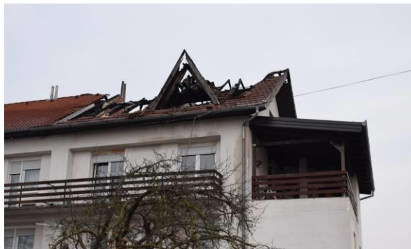
Slika 6. Opožareni objekt prije očevida
