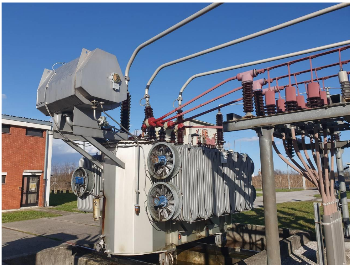
Sl. 1.: Prikaz oštećenja Tr 2 , 20 MVA u TS 110/20 kV Petrinja
