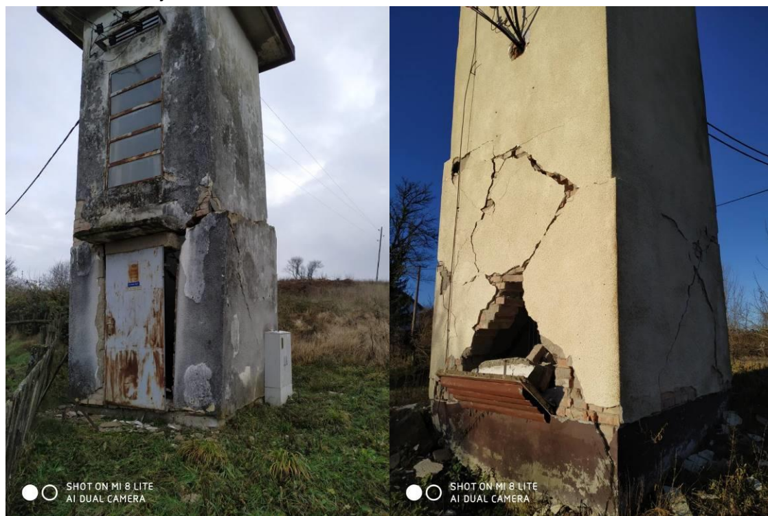
Sl. 4.: TS 20/0,4 kV, Staro selo i TS 20/0,4 kV Vukoševac u TJ Hrvatska Kostajnica.
