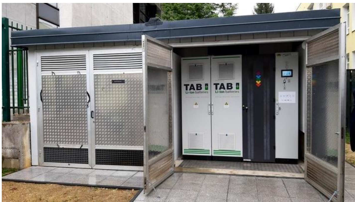
Slika 1. TP Gimnazija Velenje i ugrađen baterijski sustav AMBER
