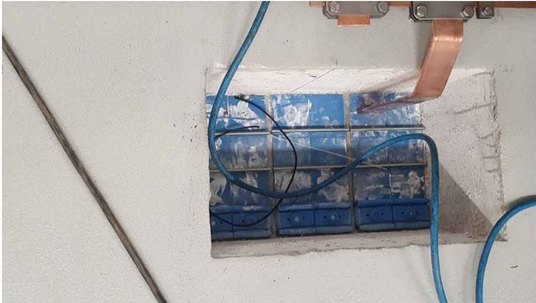
Slika 7.: TS SUČIDAR 110 kV GIS
