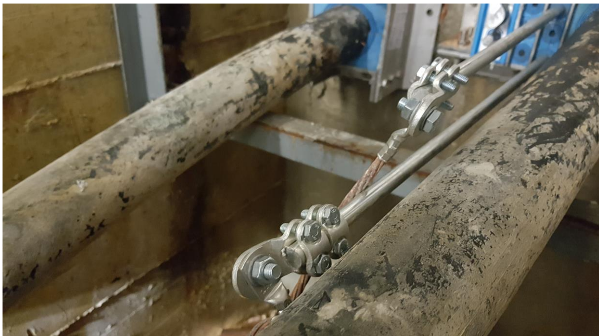
Slika 5. Ulaz kabela i Cu užeta za uzemljenje u TS 110/20(10) kV KSAVER
