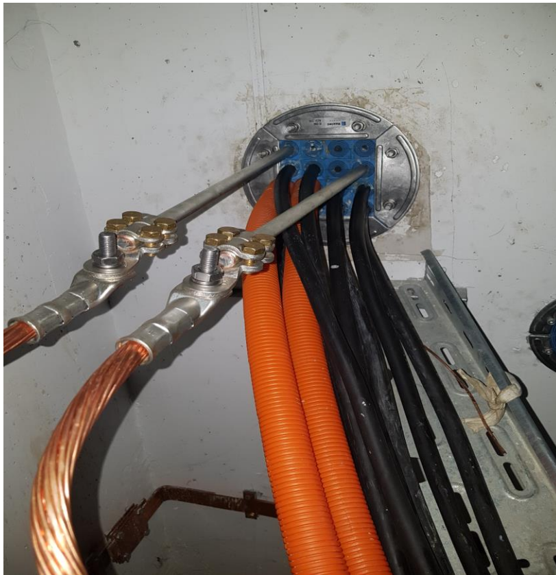
Slika 4. Ulaz kabela i Cu užeta za uzemljenje u TS 110/20(10) kV SESVETE
