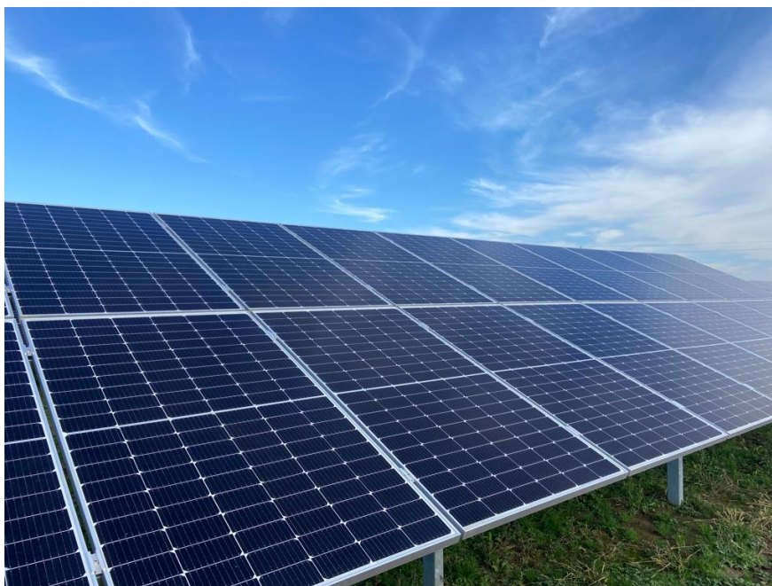
Slika 1. Solarni paneli instalirani u solarnoj elektrani velike snage
