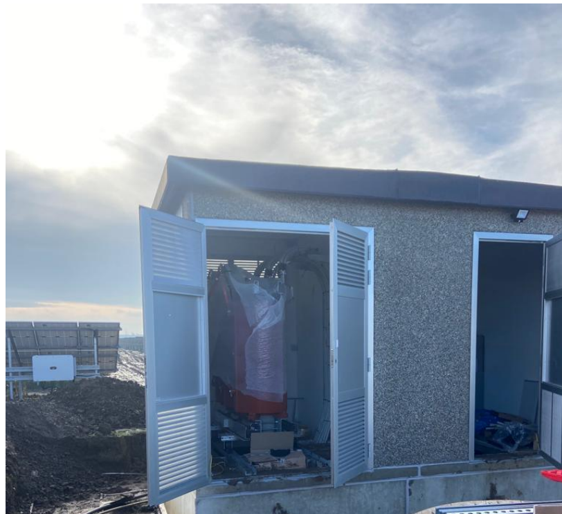
Slika 3. Smještaj transformatora u betonsku kućicu
