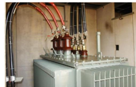
Transformator po čišćenju
