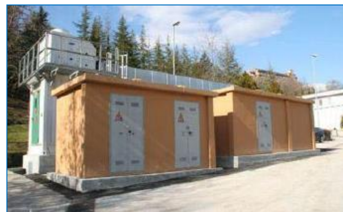
primjer BSPEE 1MVA/500kWh, Li-ion priključeno na Srednji napon, u pogonu od 2012. prema: Grid4EU, Demo4, ENEL Isernia project
