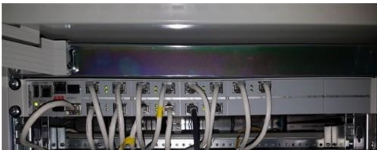
ABB preklopnik za IEC61850 u postrojenju
