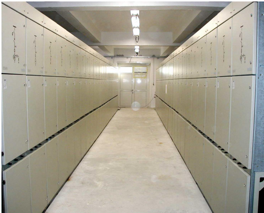
Slika 15. Sklopno postrojenje KSMV 4 – 2500 A, ukupno 50 polja
