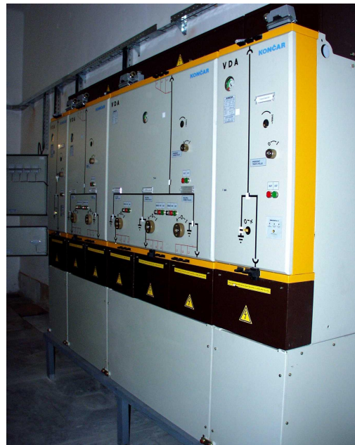
Slika 8. Sklopno postrojenje VDA 12(24)kV; HEP DP Elektra Zagreb - TS 10(20)/0,4 kV Frankopanska (konfiguracije polja T+sD2V+3V+T)
