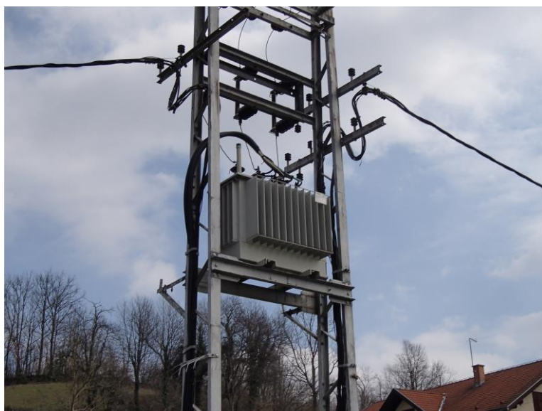
Slika 1. Transformator u radu
