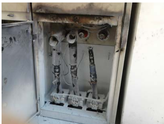
Slika 1 - Oštećenja na priključnom ormaru
