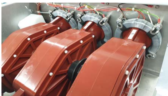
Slika 2 – Unutrašnjost kućišta rastavne sklopke
